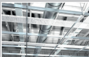
Kabeltritten und Lüftungskanäle
