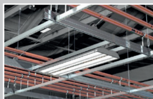
Rohrleitungen und Lampen
